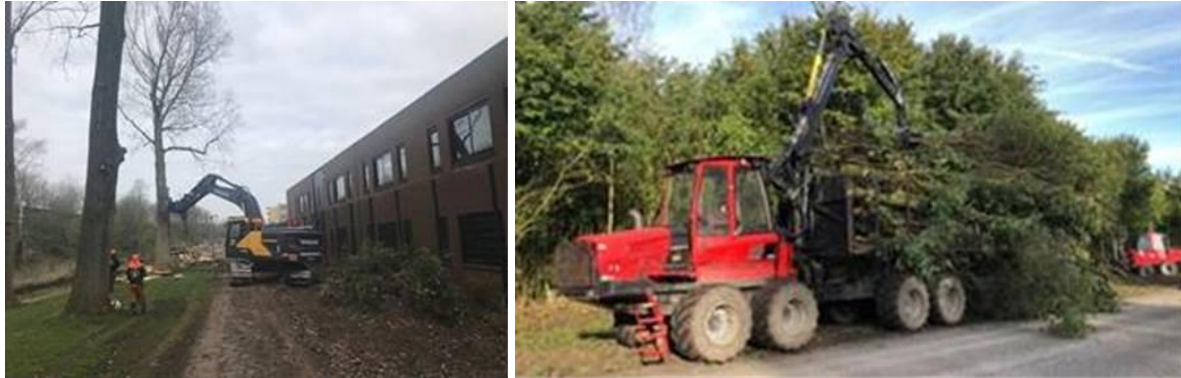
Figuur 4. Boomooogstwerkzaamheden in opdracht van RWS. Links: Kraan met grijpklaauw (Volvo CE300) en kettingzaag gebruikt voor het vellen van bomen; Rechts: forwarder (Komatsu 865) voor het uitrijden van gevelde bomen (Foto's: Coos Aalbers, RWS).
